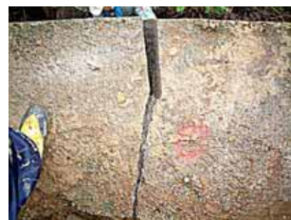
コンクリート破壊状態
